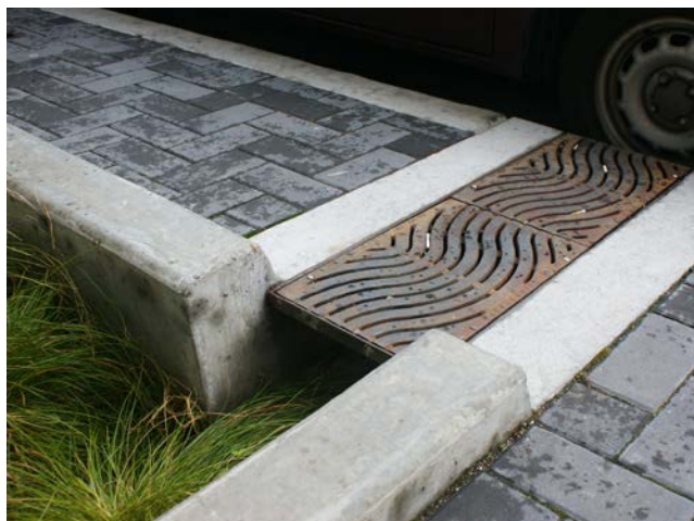
Referensbild, SWECO: dagvattenhantering, vattenränna
