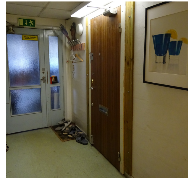
Ursprunglig dörr med sidoljus och frostade glaspartier. Till höger en sekundär dörr.
