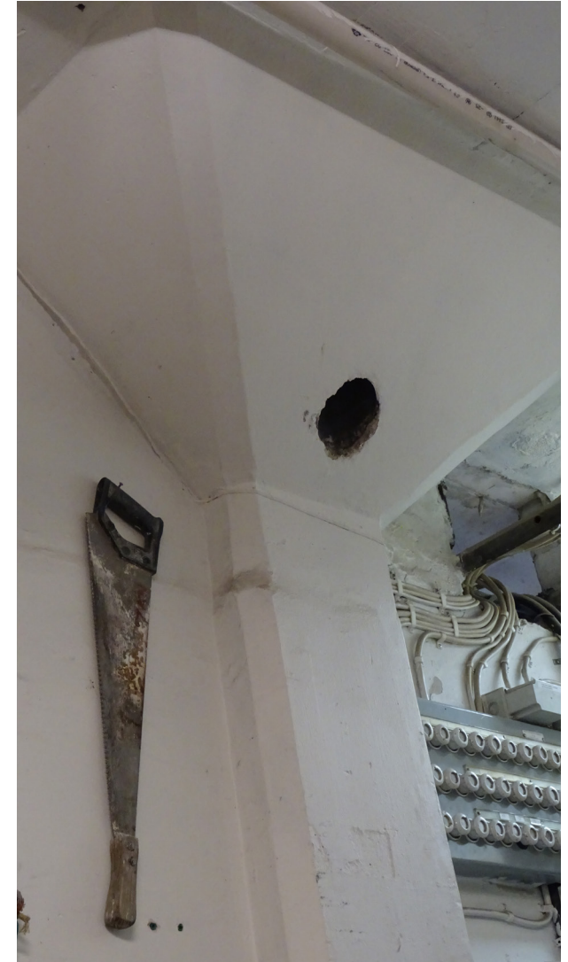
Pelare vid ursprunglig vägg på våningsplanets mitt. Hål enligt muntlig uppgift med anknytning till färgtillverkningsprocessen.
