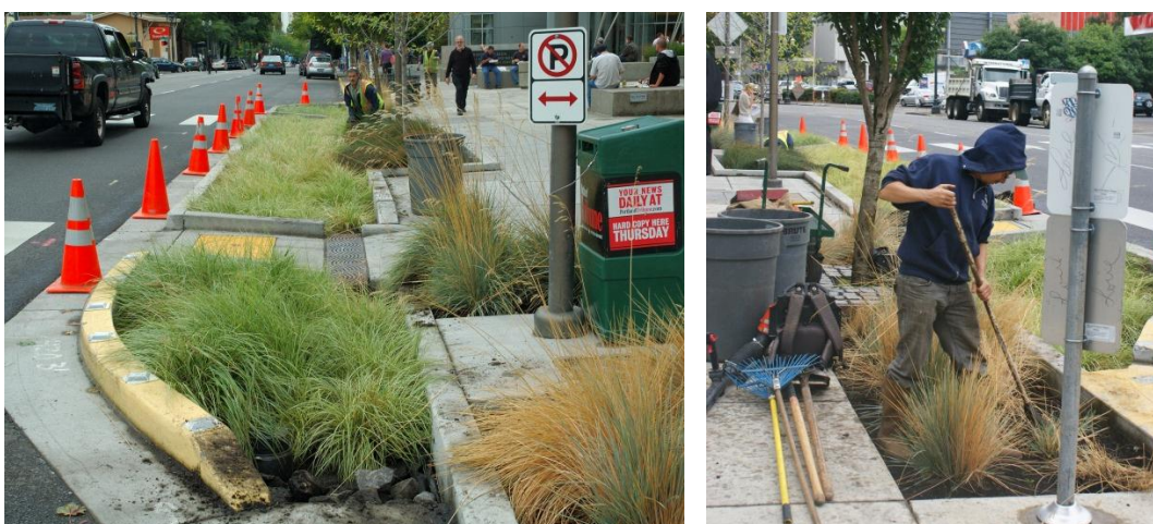
Figur 13 Skötsel av LOD-anläggningar genomförs 2 gånger per år i Portland, USA.
