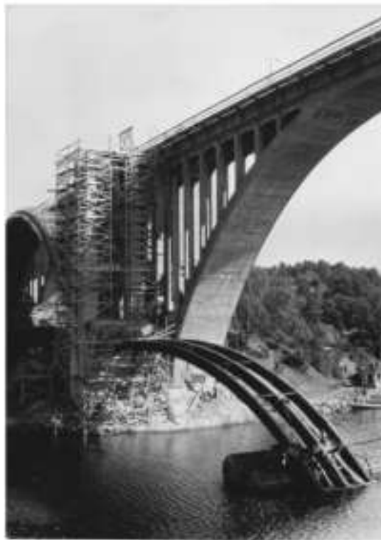
Fyrtio ton stål hissas upp för att bli underlag för gjutningen av parallellbronns östra halva.
